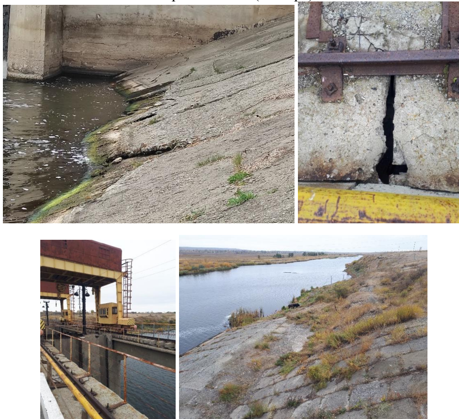
Рисунок 2 – Недостатки технического состояния сооружений и конструкций водохранилищ
